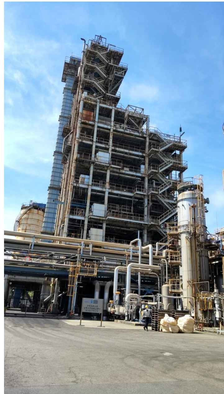
低温+高温のガス化炉：アンモニア製造2022.06.29 竹谷撮影
