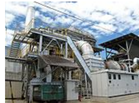
燃焼プラント
